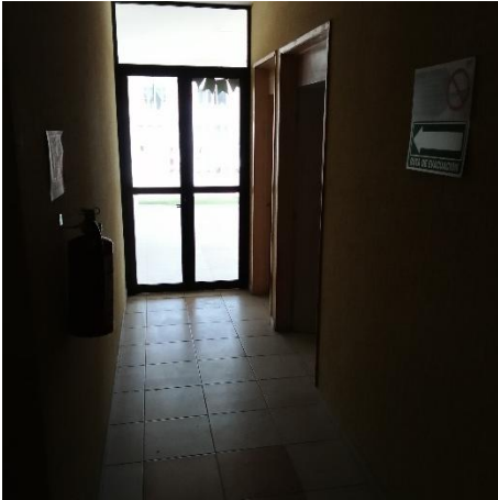
Figura 20. Pasillo de acceso a sanitarios con poca iluminación.
