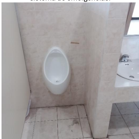
Figura 38. Mingitorio sin barras de apoyo y sistema de emergencias.
