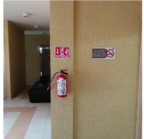
Figura 22. Señalética a 1.60 cm de altura, sin uniformidad en su instalación.
