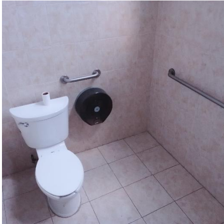
Figura 41. Baño para PcD Con barras de apoyo mal ubicadas.
