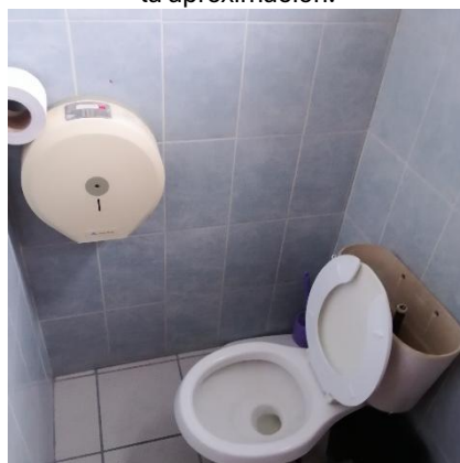
Figura 77. Mueble de sanitario deteriorado, con ubicación que no permite la aproximación.
