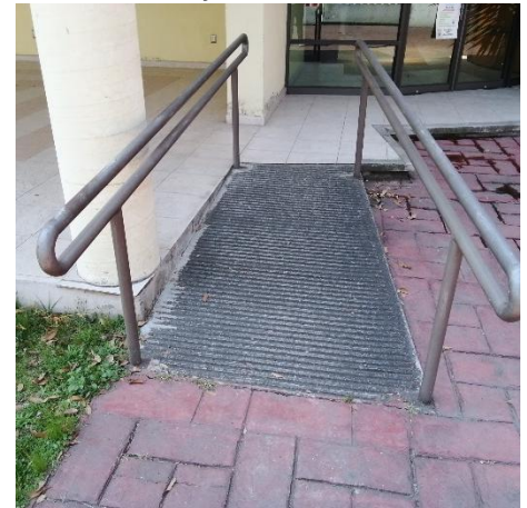
Figura 31. Rampa con ancho inicial de 1.10 m y termino en 90 cm.
