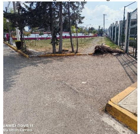
Figura 13. Zona de descanso sin bancas y senderos seguros, con piso irregular.
