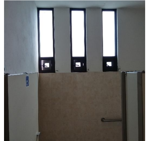
Figura 43. Baja ventilación natural por ventanas pequeñas.
