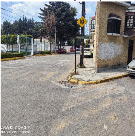
Figura 11. Banquetas en mal estado, con falta de señalización y sin rampa.
