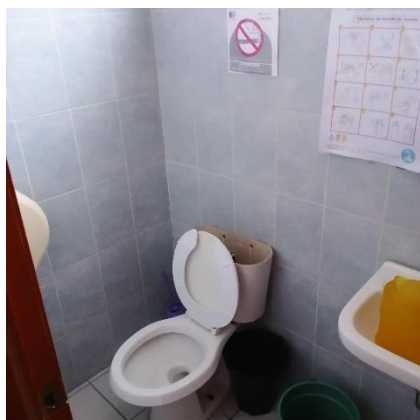
Figura 76. Distribución de sanitario inadecuada y que limita la usabilidad
