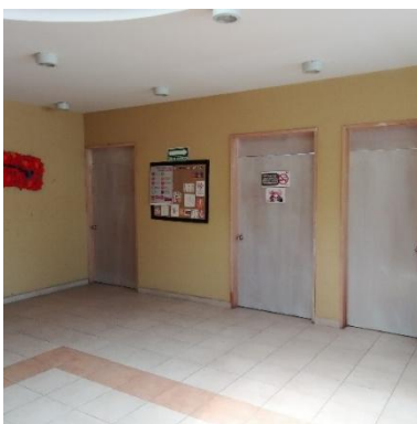
Figura 26. Puertas con señalética inadecuada y manija tipo pomo.
